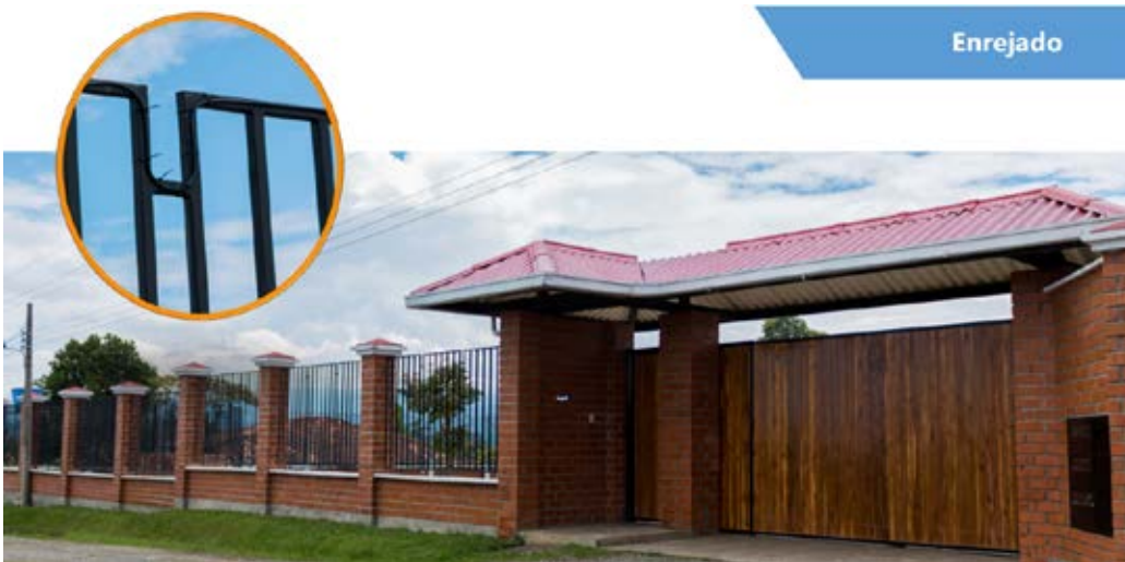
Figura 6b. Instalación en enrejado
