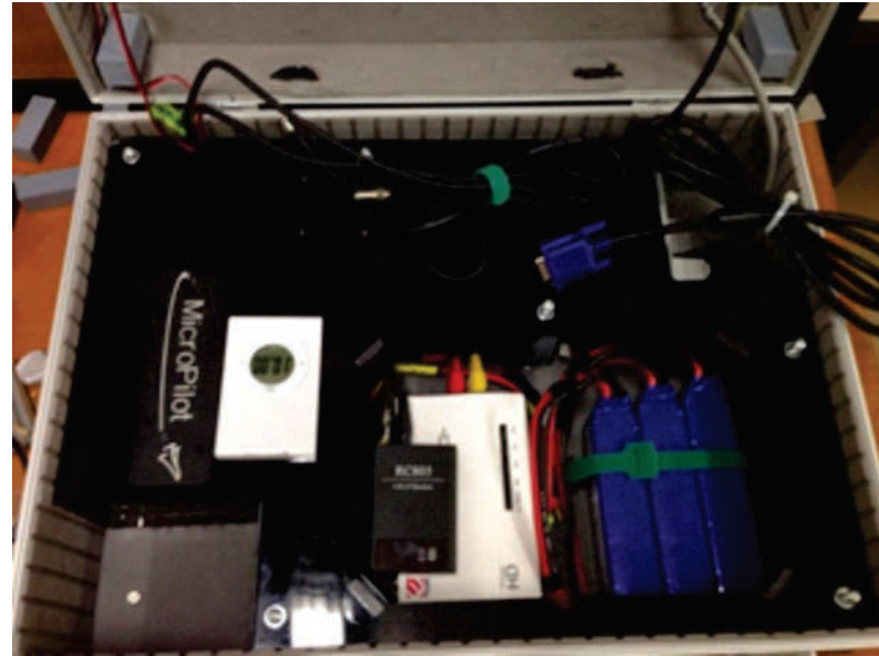
Figura 12. Distribución de los componentes al interior de la estación de control.
