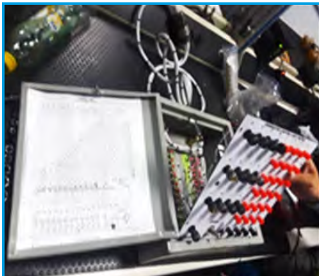
Figura 9. Ensamble del tablero y barras eléctricas. Fuente: Losada (2018).
