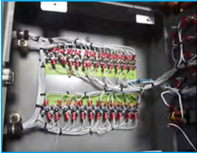
Figura 8. Conexión eléctrica Fuente: Losada (2018).
