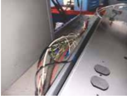
Figura 19. Antiguas Conexiones Eléctricas
