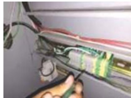
Figura 17. Observando y verificando fallas y componentes dañados
